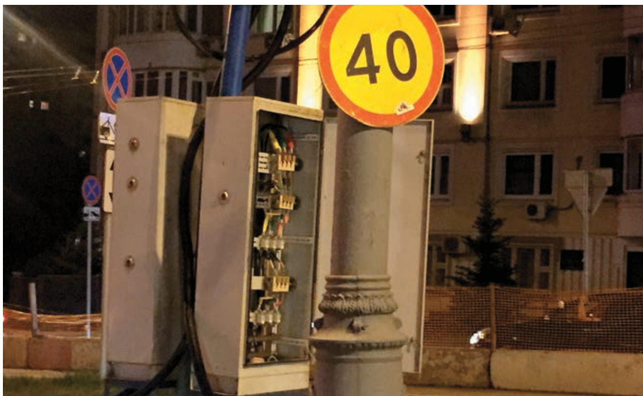
Рис. 2. Открытый шкаф системы городского освещения
